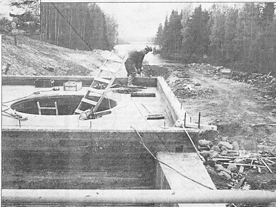
■ Stationen vid Kvarnen med sina två turbiner är en av de äldsta med anor från 1912.
