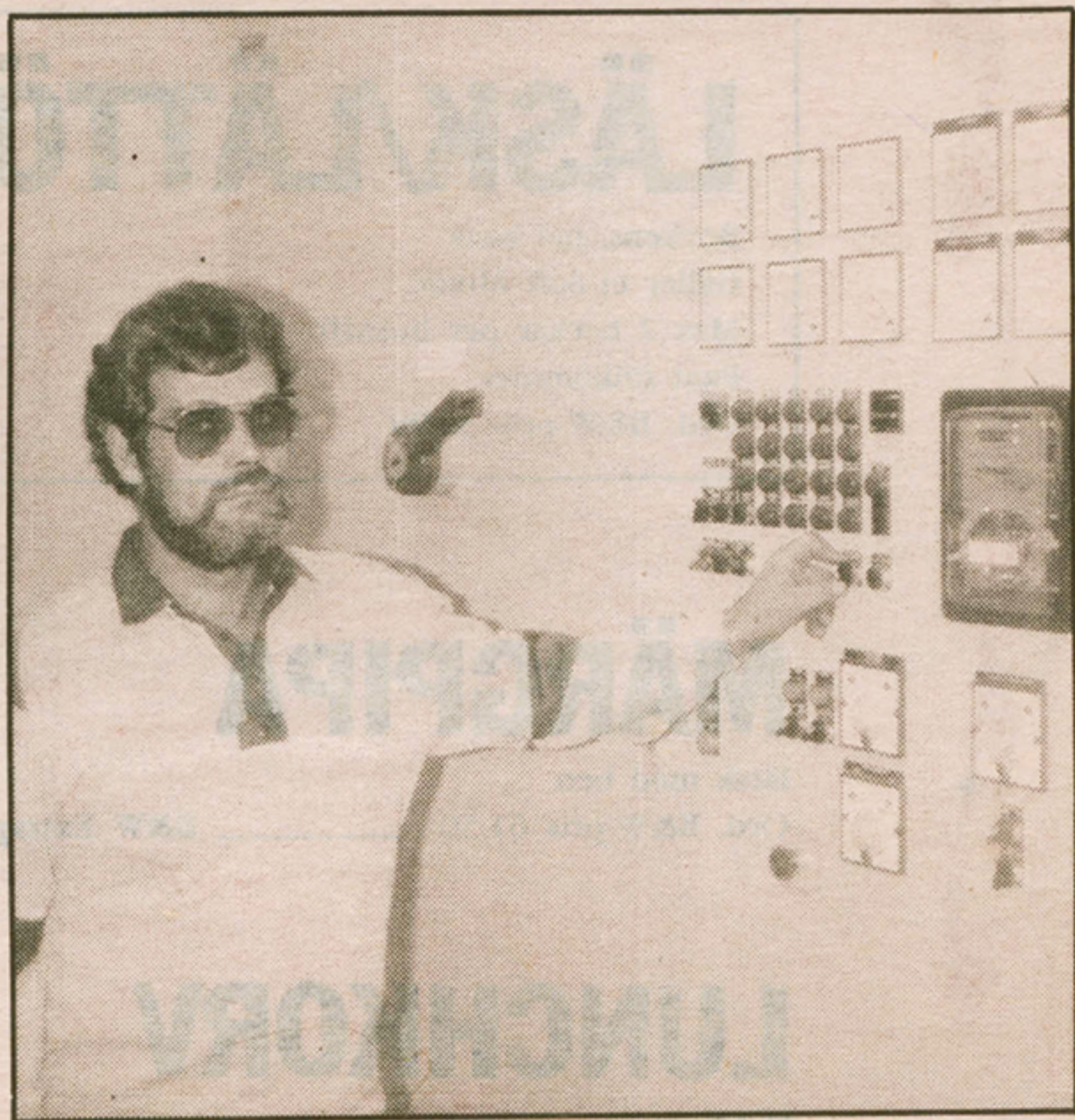
■ Kraftverksskötare Göran Sundqvist vid mätartavlan för det nya minikraftverket hos Järbo Nedre Kvarnförening.
